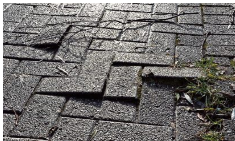
So sehen die Radwege in Nordenham an vielen Stellen aus.
